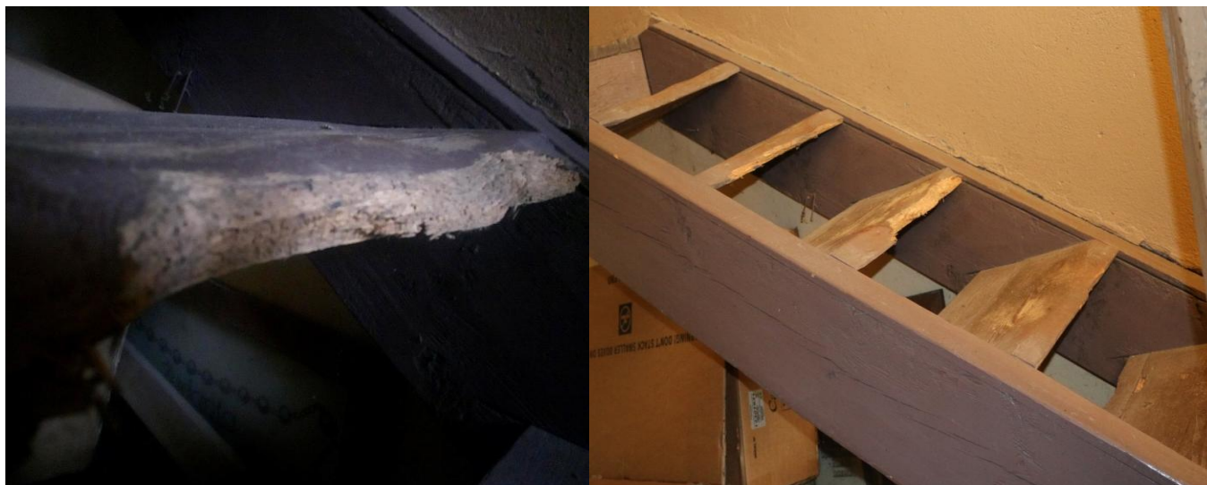
Fot.2 Drewno stąpniczy zaatakowane przez owady żywiące się drewnem
