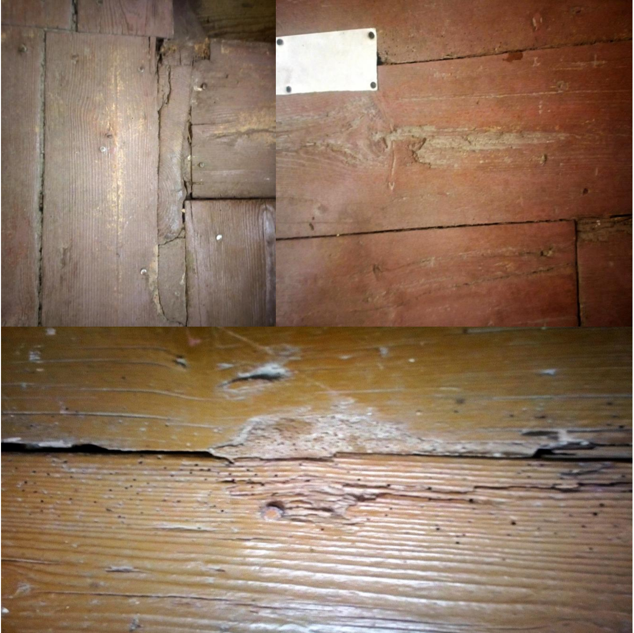
Fot.4 Podłoga na chórze widoczne zniszczenia struktury drewna;
