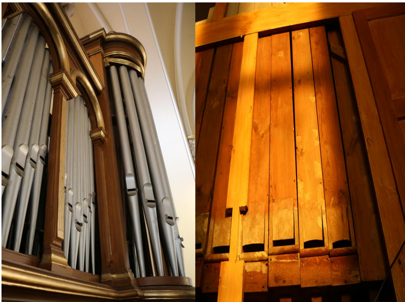
Fot.11,12. Widok na piszczałki frontowe oraz tył szafy organowej z brakującymi płytkami
