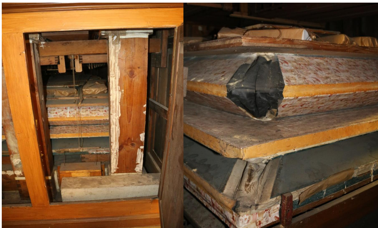
Fot.1,2. Miech główny, kalikant, regulator przepływu powietrza; widoczne uszkodzenia i prowizoryczne próby uszczelnienia
