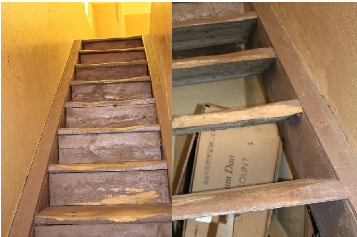
Fot.1 Widok na uszkodzenia schodów
