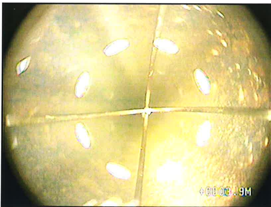
Fot. Widok: lustro statyczne L_s = 3,9 m p.p.głowicy studni, tzn. ok. L_s = 5,7 m poniżej powierzchni terenu.
